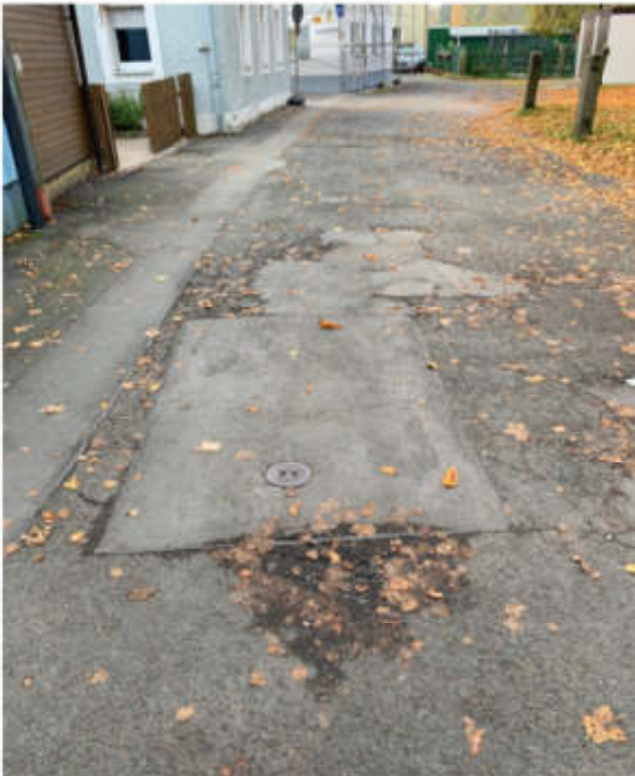
Fabrikgasse - mangelnde Oberflächenqualität der Straßen
