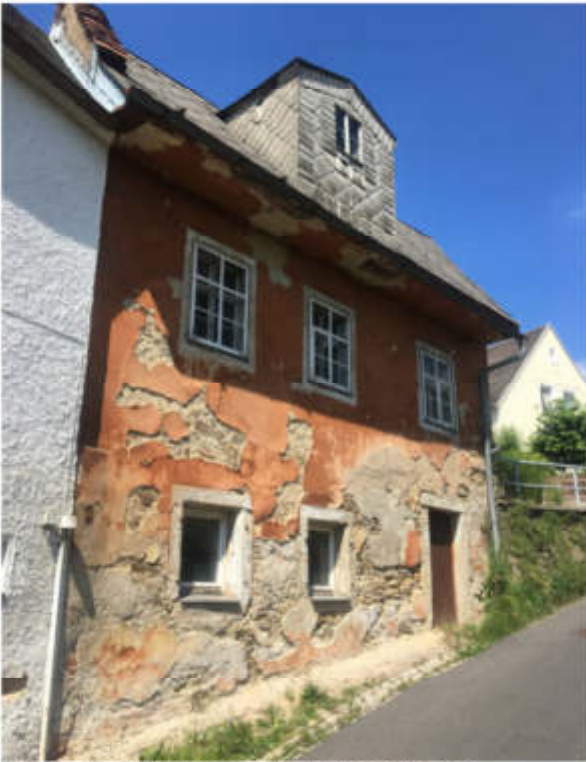
Bühlstraße- Sanierungsstau / Verfall der Bausubstanz
